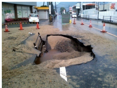
山口県萩市道路陥没事故(2009年)
