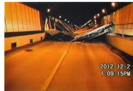
笹子トンネル天井板落下事故(2012年)
